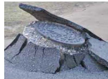
液状化により隆起したマンホール
