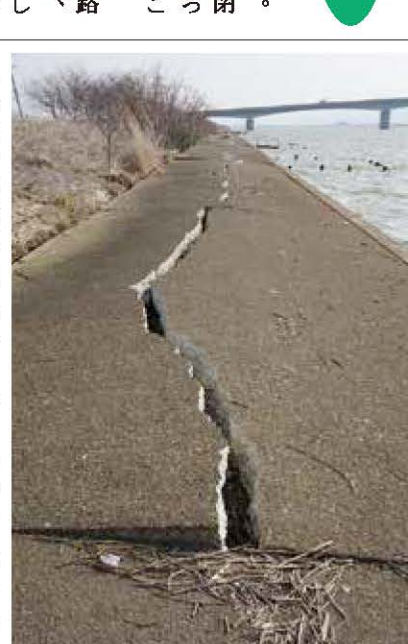
堤防に亀裂が入った
