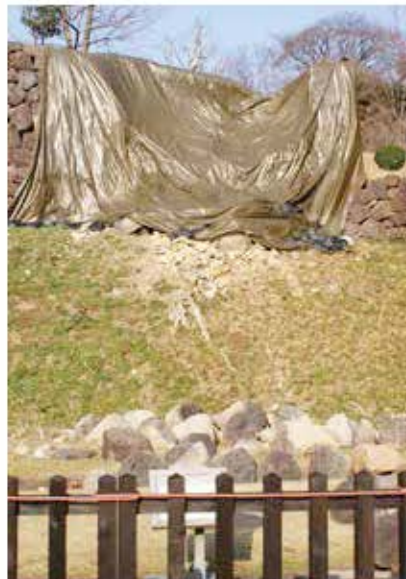
崩落した金沢城の「いもり堀の石垣」
