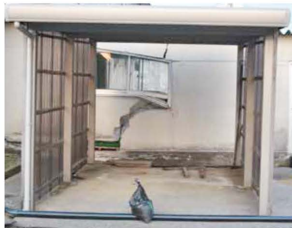
縦方向に亀裂が入った渡り廊下と仮設の下水道パイプ（手前）
