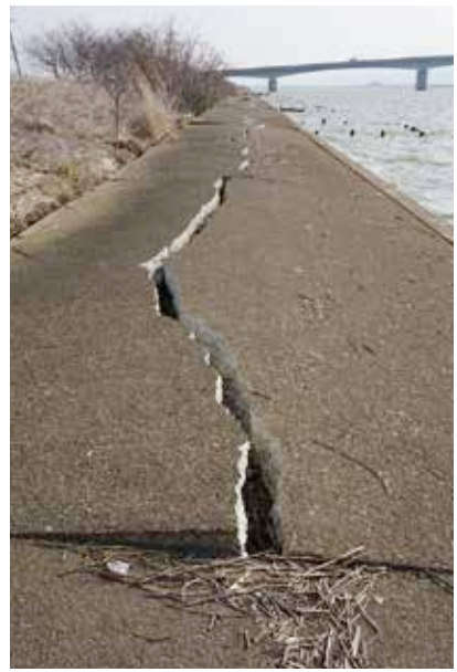
堤防に亀裂が入った
