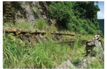
地盤が削れ傾いて使えなくなった線路
