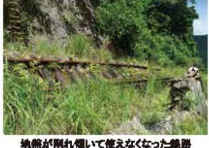
地盤が崩れ傾いて使えなくなった線路
