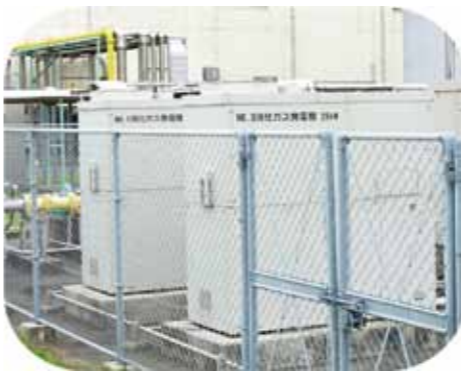
下水処理で生じたバイオガスの発電機 それを人間が食べて排出する。リンは富栄養化の原因物質だ。博多湾の赤潮の発生を防ぎ水質保全に努めるため、福岡市道路下水道局は、リン除去高度処理施設を導入している。福岡市は、平成8年からリンを回収
