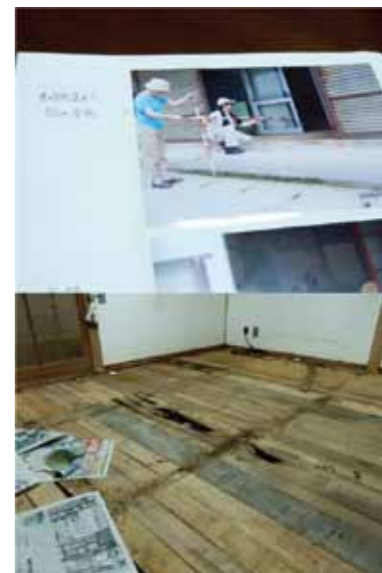
生々しく残る浸水の痕跡
